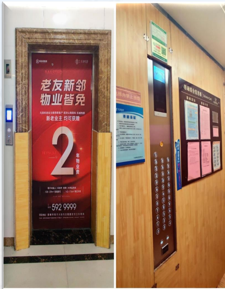
电梯控制系统
