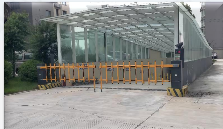
停车场出入口管理系统
