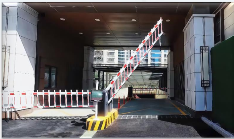
停车场出入口管理系统
