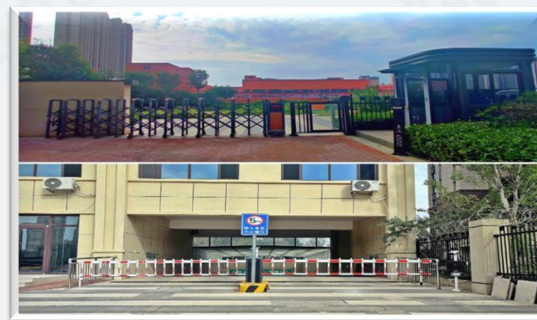
停车场出入口管理系统
