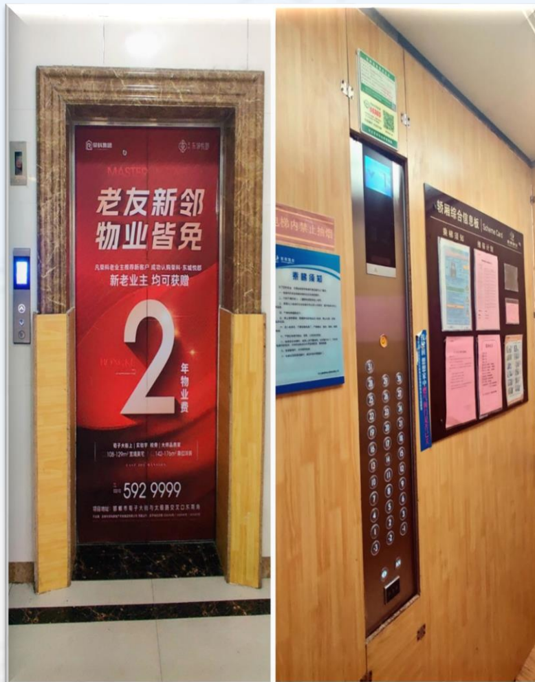
电梯控制系统
