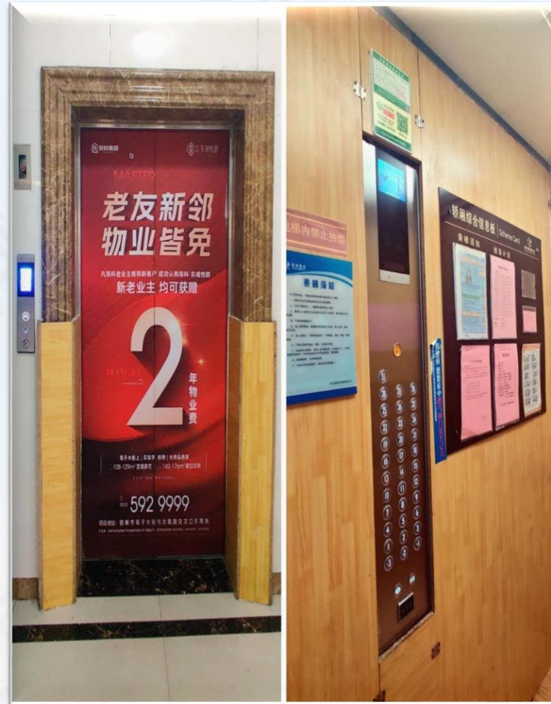
电梯控制系统
