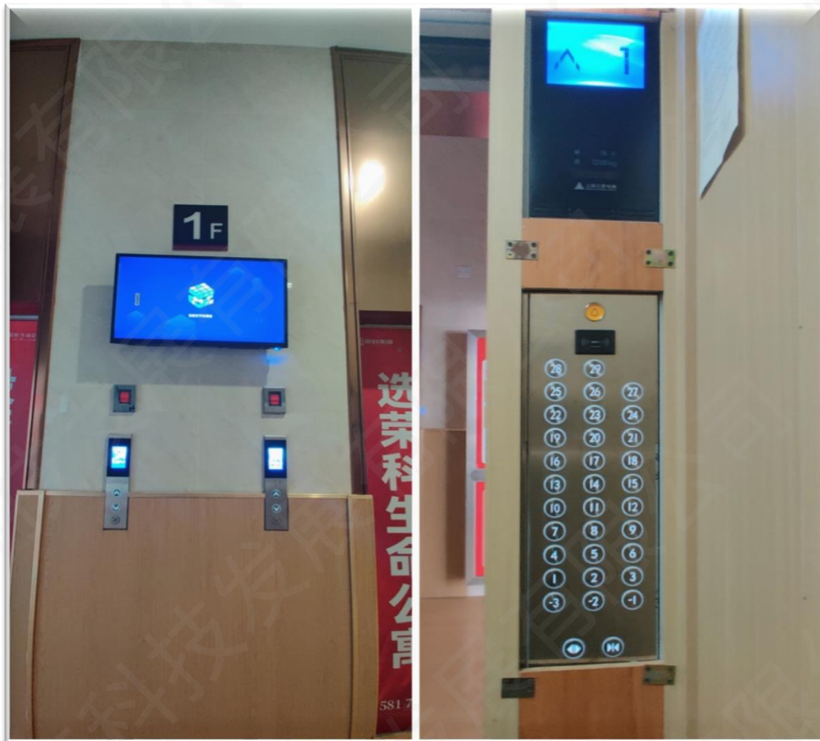
电梯控制系统
