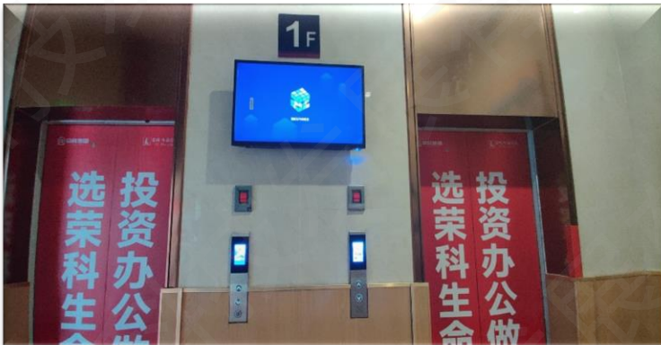
电梯控制系统
