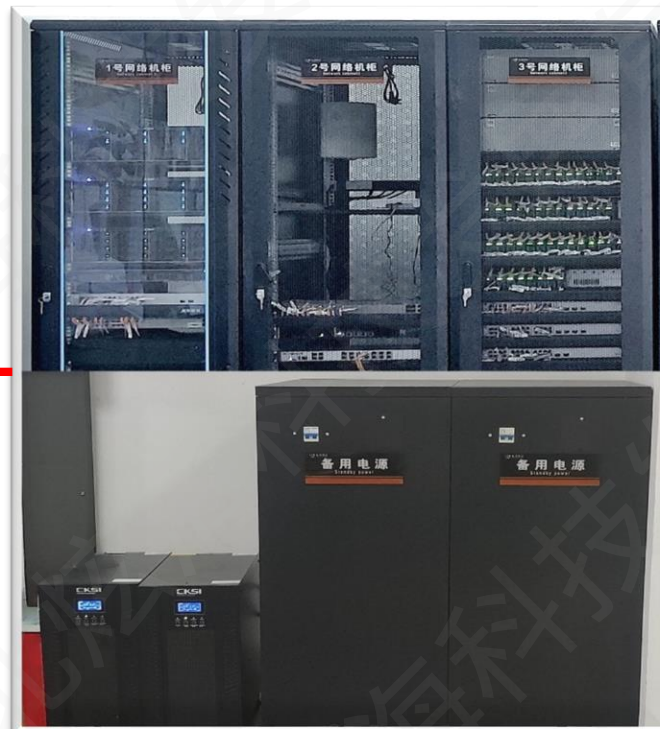
服务器机柜和UPS电源
