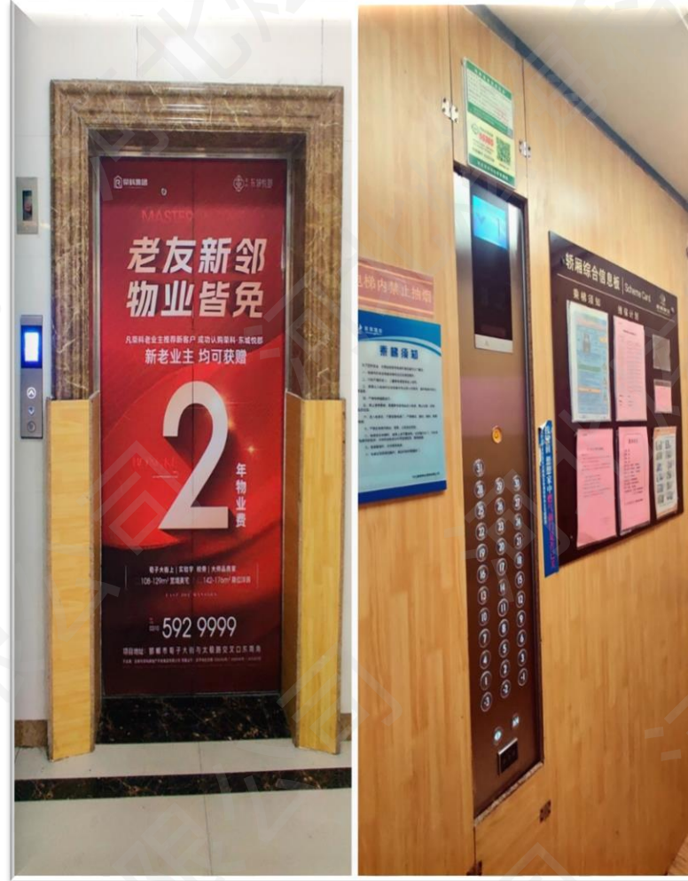
电梯控制系统
