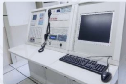
第三方对接 (消防/监控)
