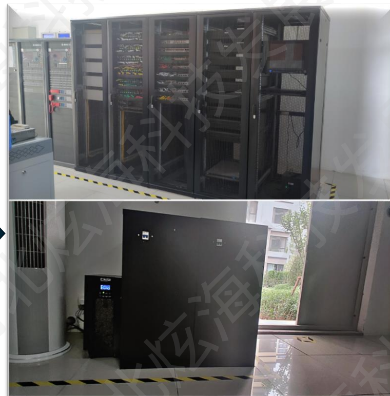
服务器机柜和UPS电源
