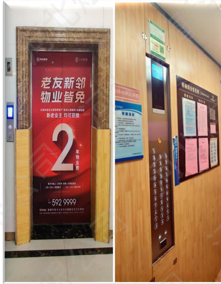
电梯控制系统
