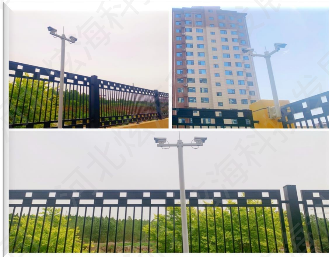
园区围墙的周界监控
