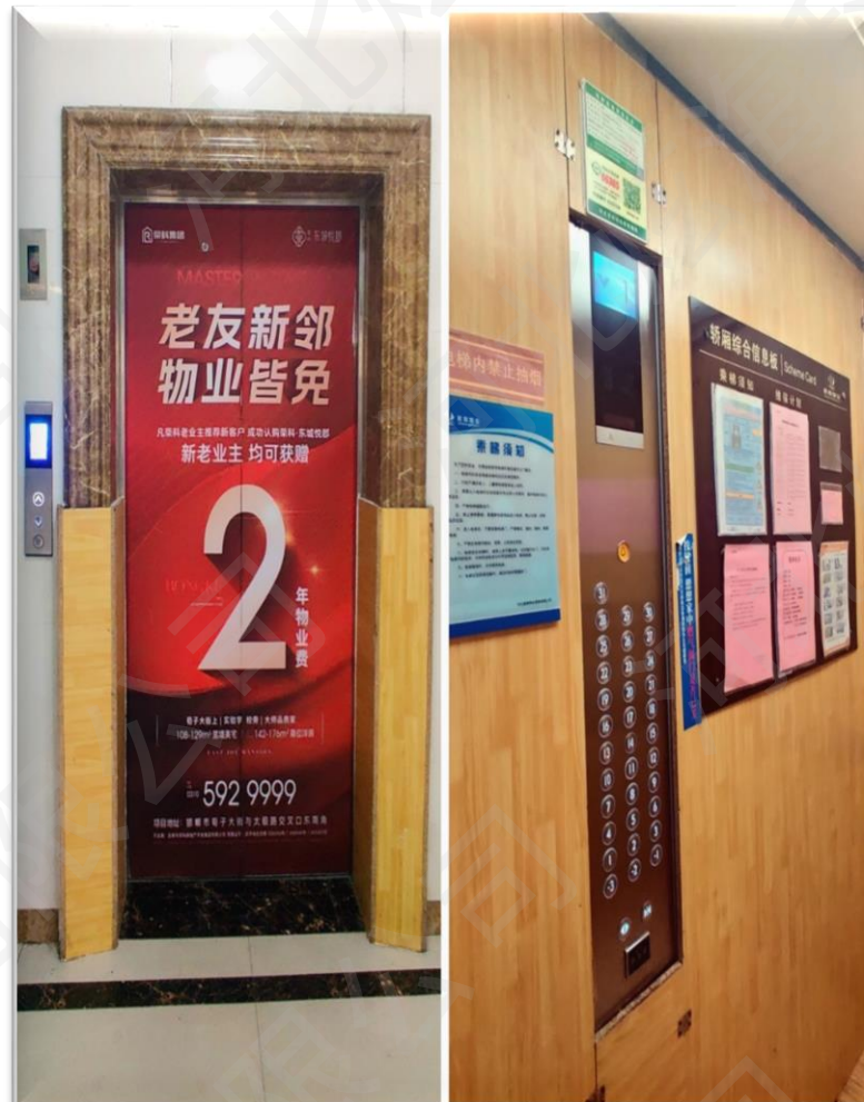
电梯控制系统
