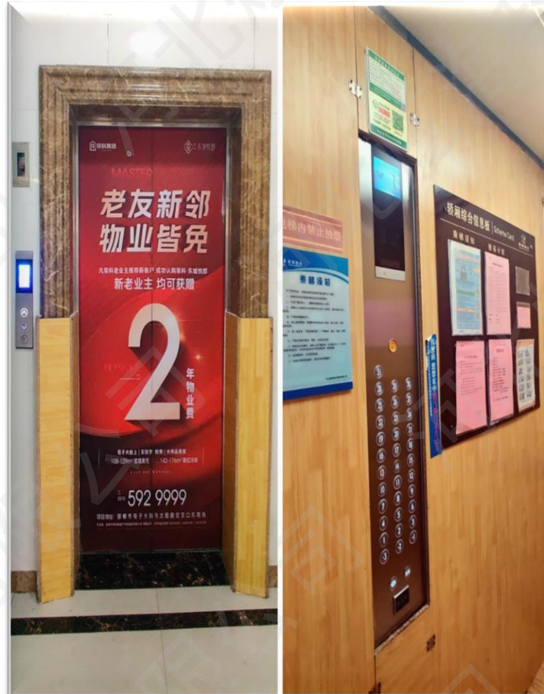
电梯控制系统
