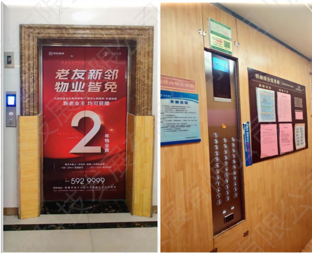
电梯控制系统
