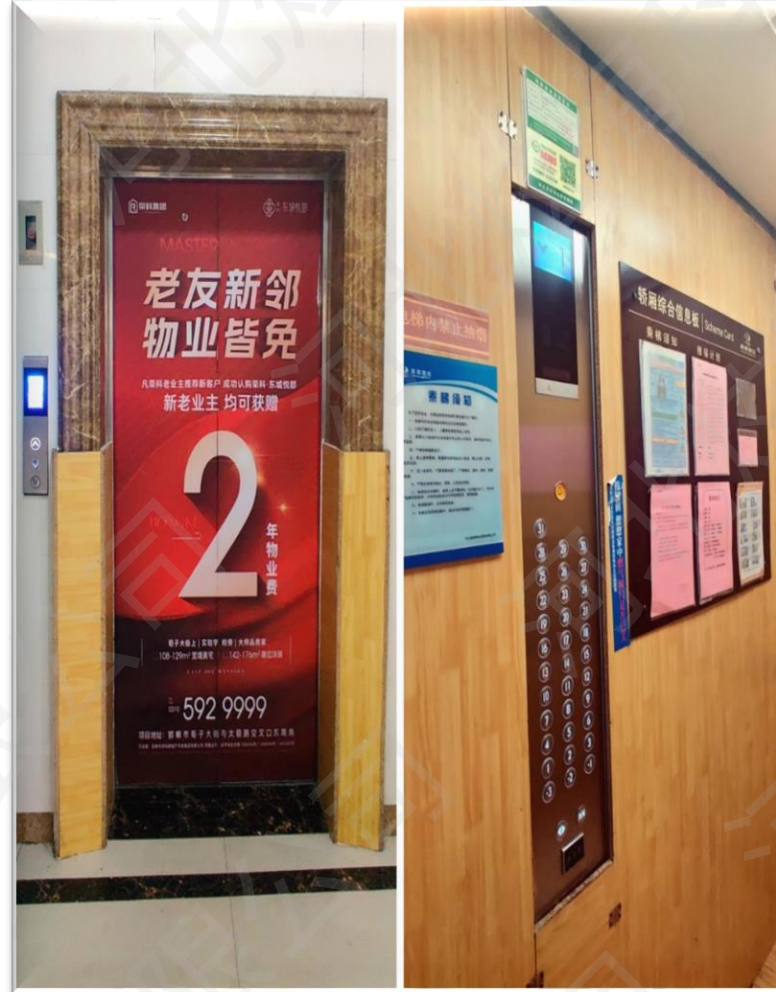
电梯控制系统
