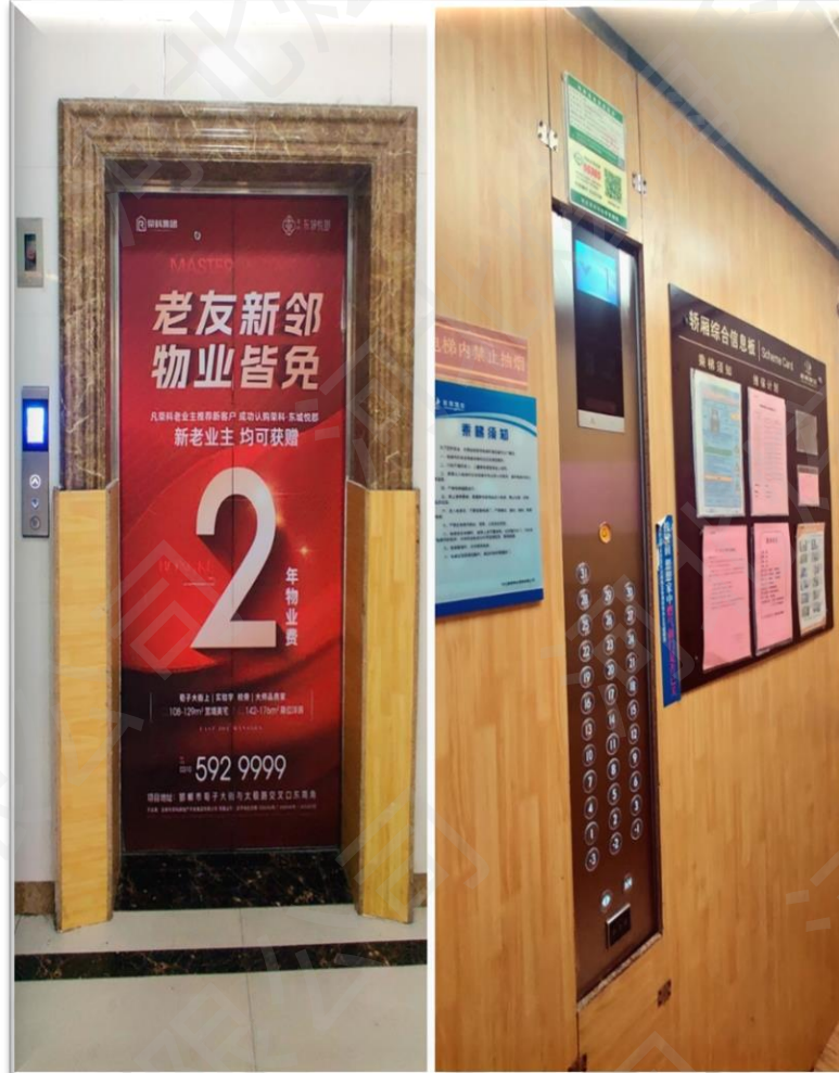
电梯控制系统
